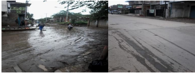
Gambar 6. Kondisi lumpur di jalanan dan perkerasan jalan
