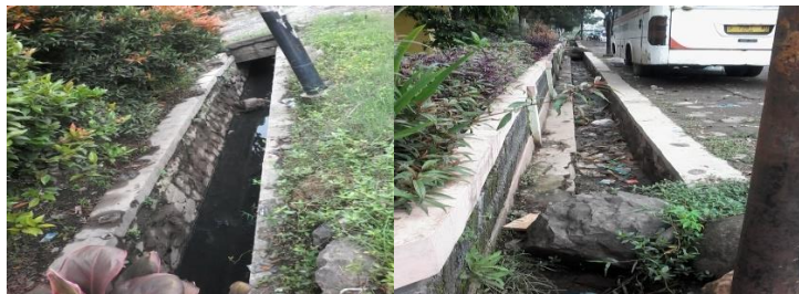
Gambar 7. Kondisi drainase di Kelurahan Baleendah dan Kelurahan Andir
