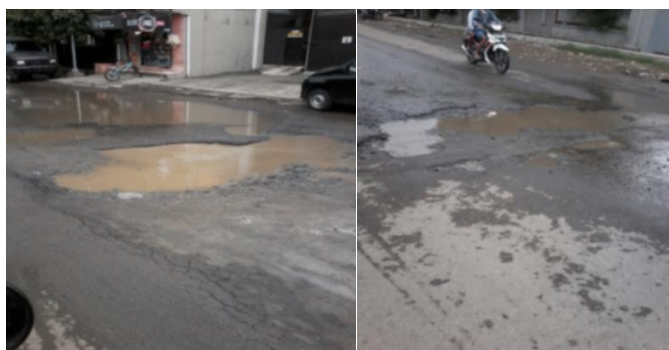
Gambar 5. Kondisi titik jalan rusak di Kelurahan Baleendah dan Kelurahan Andir
