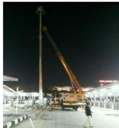
Gambar 6. Penangkal petir pada menara lampu penerangan parkir bandara Kualanamu
