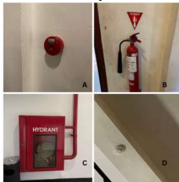
Gambar 2. (A) Alarm Kebakaran, (B) APAR, (C) Pompa Hydrant, (D) Pendeteksi Asap
