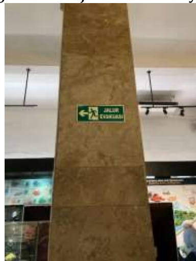
Gambar 3. Pemasangan rambu jalur evakuasi yang melebihi 2 meter
