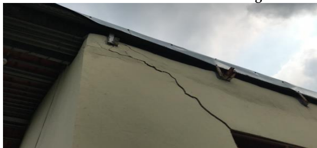
Gambar 2. Retakan di Areal Permukiman Warga Desa Bunder
